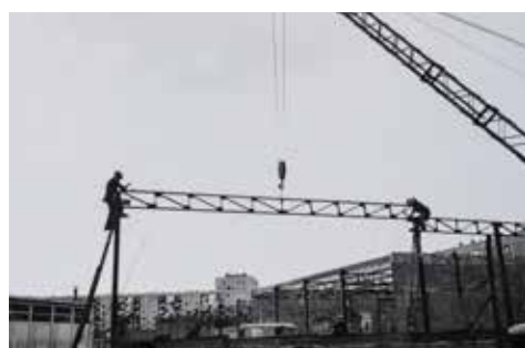
Le chantier de l'école maternelle des Glonnières 1967 Photographie (reproduction) © Archives du Mans
